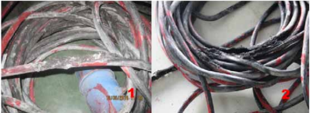
Gambar. Kondisi Extension Cable Sebelum [1] dan Sesudah [2] Terbakar
